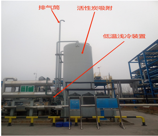
装卸台油气回收及取样口
