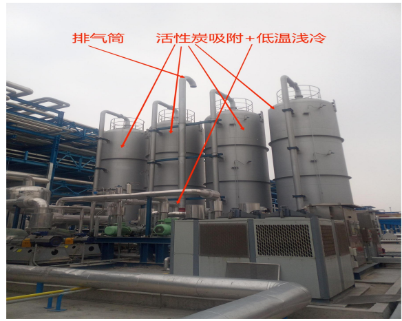
罐区油气回收及取样口
